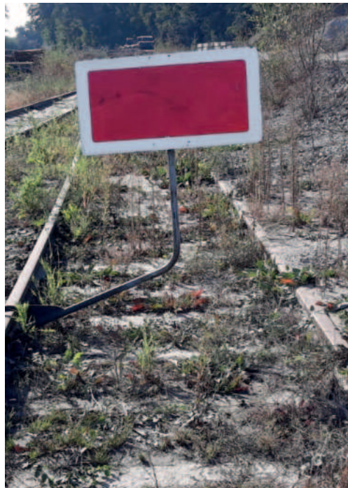
Die Einstellung des Betriebes auf der Primstalbahn steht bevor: zu viele schadhafte Schienen und Schwellen
