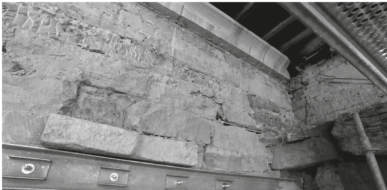
Bröseliges Mauerwerk und T-Träger, Foto: Christoph Schwingel (SR)
